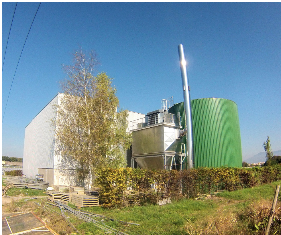
Caldia a legna dotata di un open buffer e di un filtro particolato: un'alternativa ecologica per riscaldare le serre con energia rinnovabile (© UFAG)
